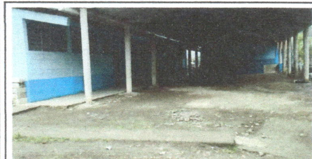
Foto 3: EL PISO DEL SALON ESTA EN MAL ESTADO, SE REQUIERE ENTORTADO.
